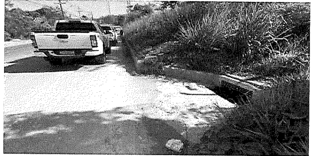
Foto 2 - Boca de lobo, material sólido da foto 1 está a frente do veículos
