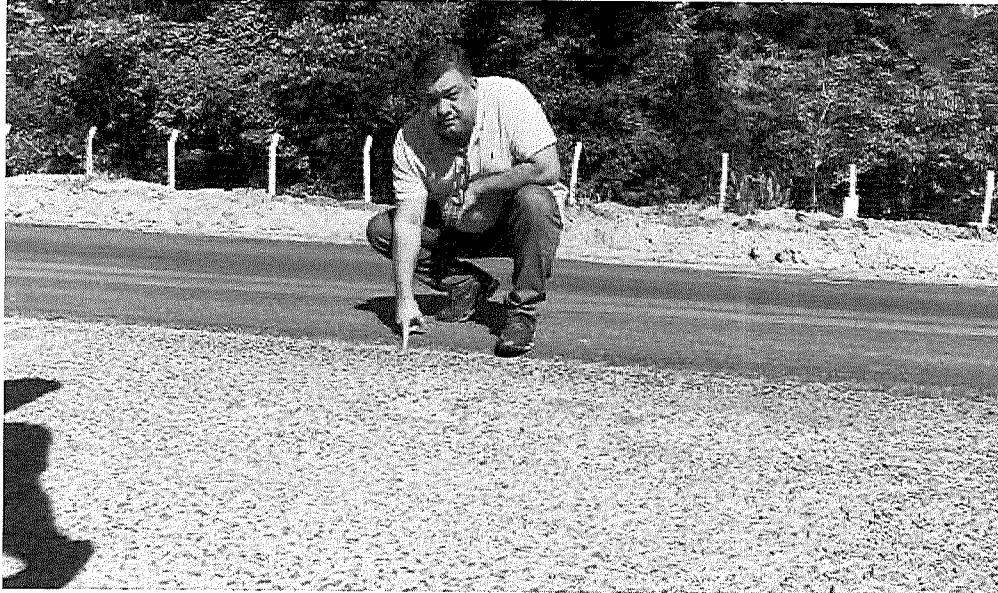
Foto 5 - Revestimento com espessura inferior a 3,5 cm
