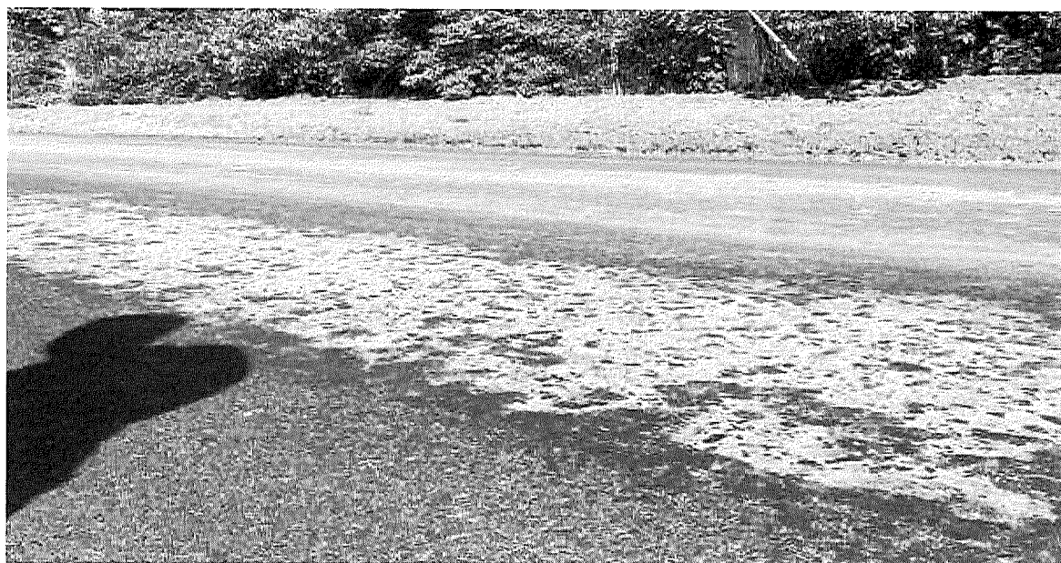
Figura 03: O que é mostrado na imagem da foto é uma base com compactação fora dos padrões de norma, que mesmo após a aplicação do TSD, apresentou ruptura (buracos) nas marcas do rolo de patas.
