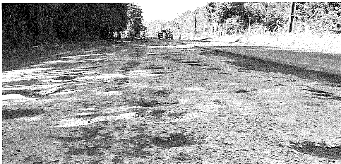
Figura 02: Base finalizada no km 10,9, com o lançamento do TSD, que não resistiu à abertura do tráfego com o aparecimento de buracos, e mesmo assim, foi feito o revestimento com CAUQ em uma das faixas, como pode-se
