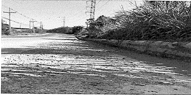
Foto 1 - Retenção de material sólido a montante da boca de lobo
