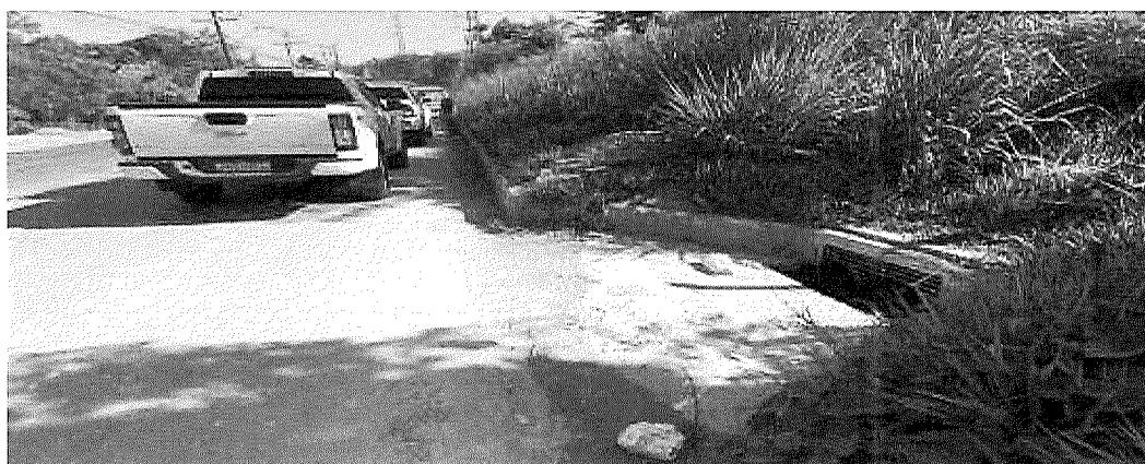
Figura 03: Dispositivo de drenagem de águas pluviais, tipo boca-de-lobo, que deveria estar localizado no ponto de inflexão vertical para que não houvesse retenção de sólidos a montante, na foto os sólidos estão à frente das pick-ups.”
