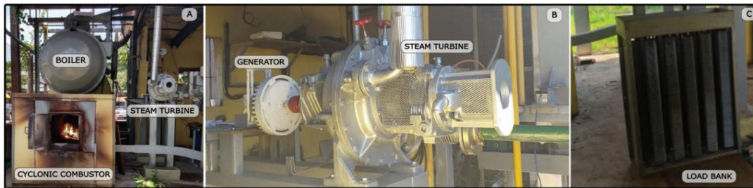
Figura 2: A bancada experimental utilizada no estudo, caldeira de combustão ciclônica e turbina a vapor (A), gerador elétrico de ímã permanente e turbina a vapor (B) e banco de cargas resistivas (C).
